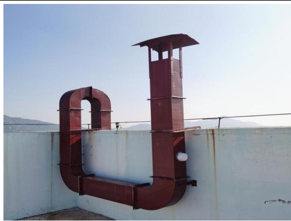
项目废气排气筒
