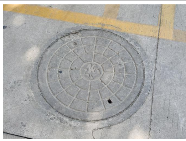
项目生活污水排放管网
